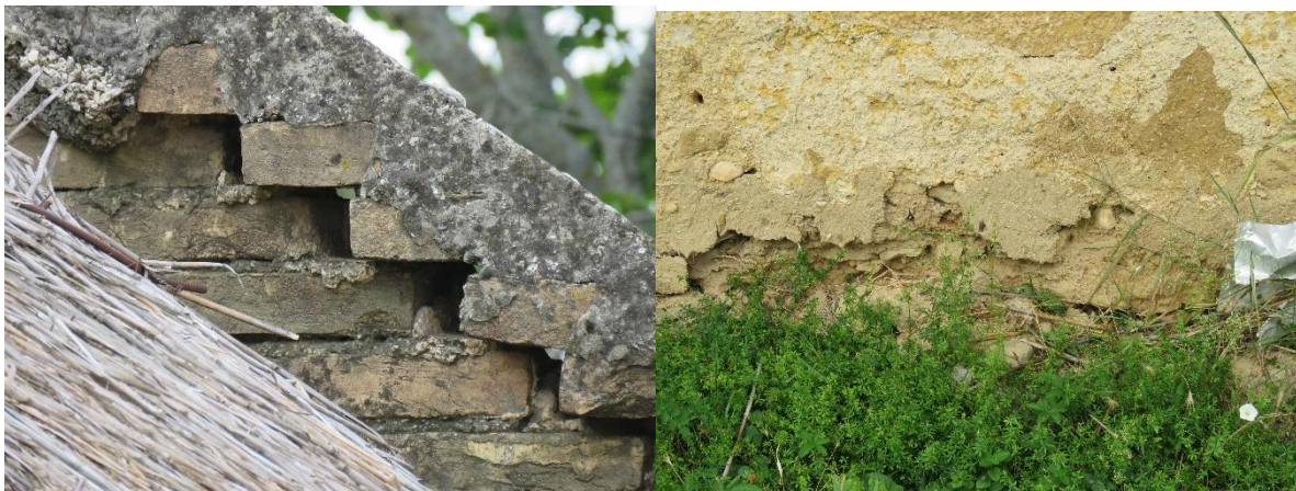
az elvált oromfal felső szegélye – pótlendő lábazati szakasz
