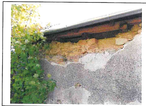
észak-keleti homlokzat - sérülés
