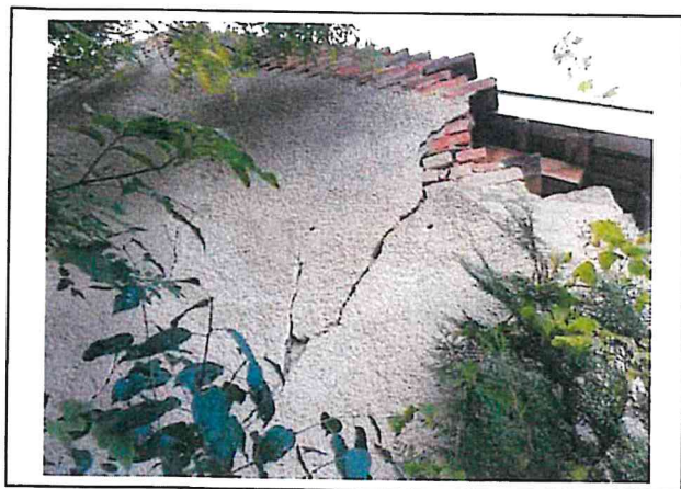
észak-keleti homlokzat - sérülés
